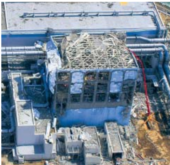
Zniszczona elektrownia w Fukushima – marzec 2011 r.
